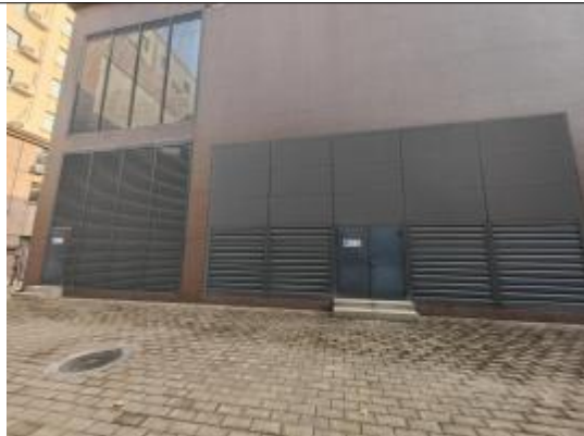
本期扩建3号主变预留位置
