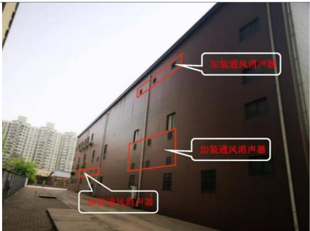
红旗220kV 变电站东面通风口降噪措施
