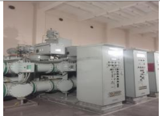
220kV 配电装置室
