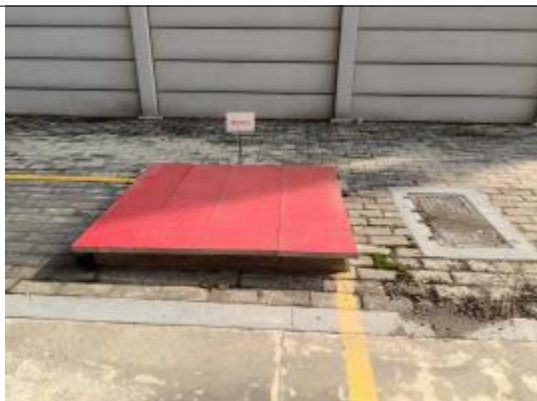
前期已建事故油池
